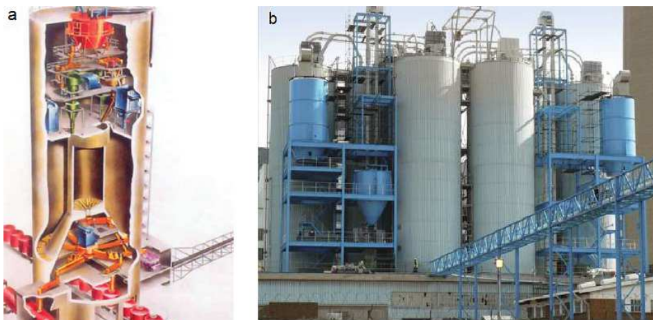
Rys. 4. Instalacje klasyfikacji popiołów lotnych i produkcji popiołów kwalifikowanych a – typowy projekt firmy Batemann instalacji klasyfikacji popiołów lotnych wkomponowanych w stacje ich składowania, zrealizowany w elektrowni w Hong Kongu; b – The Ulula Ash plant at Kreil power station, South Africa
